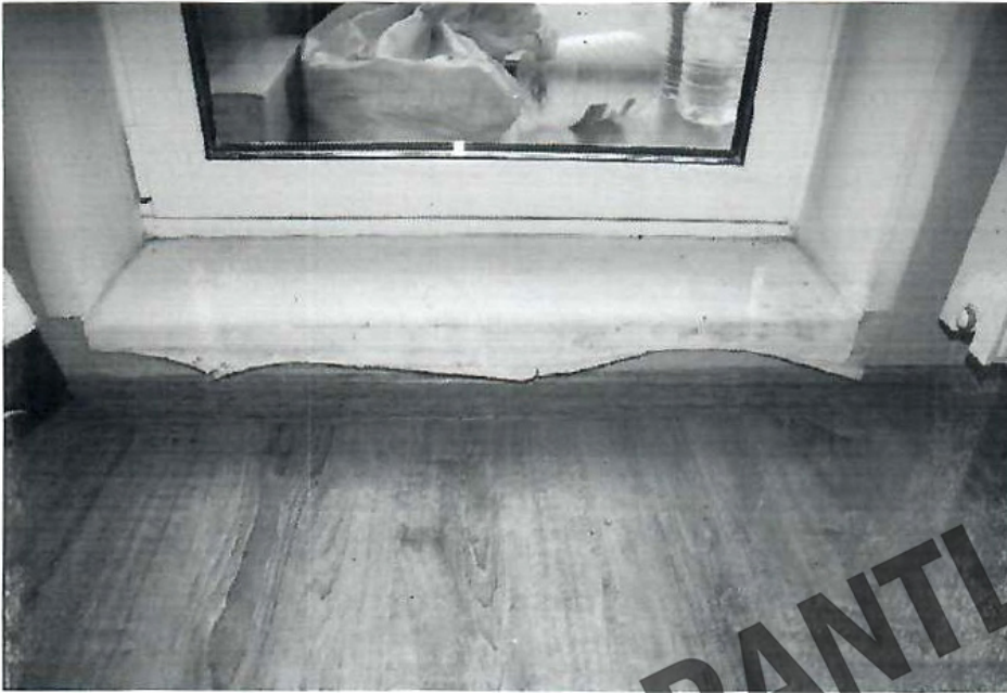
Фото 5. Отставание обоев в районе выхода на балкон
