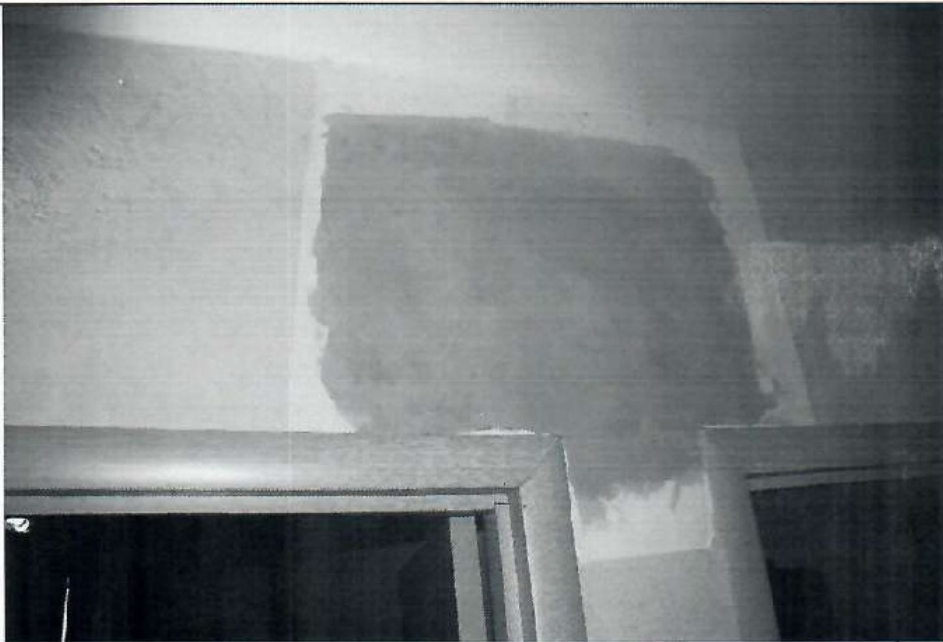
Фото 36. Зашпаклеванная трещина межкомнатной перегородки
